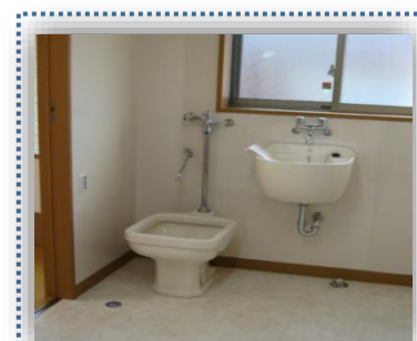
汚物流しと洗濯流し
