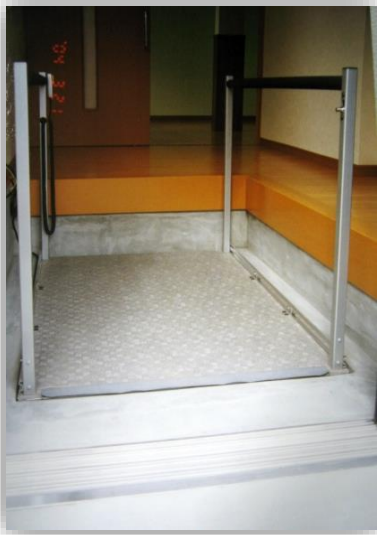
玄関内段差解消機
