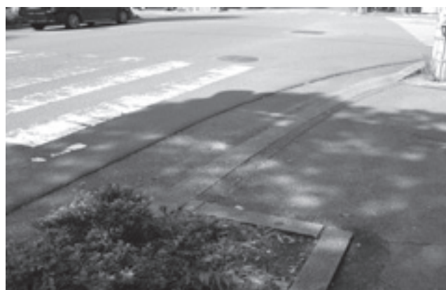
横断歩道前の段差
