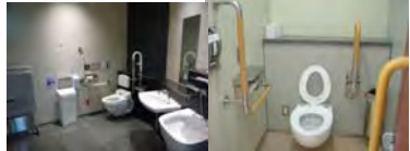
多機能トイレ 簡易多機能便房
