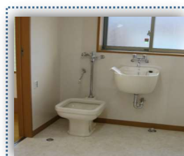
汚物流しと洗濯流し
