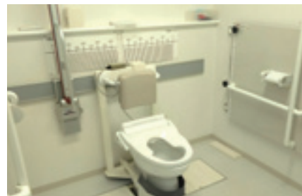
写真3 トイレフィッティングルーム； 見学・体験できる設備の1つ
